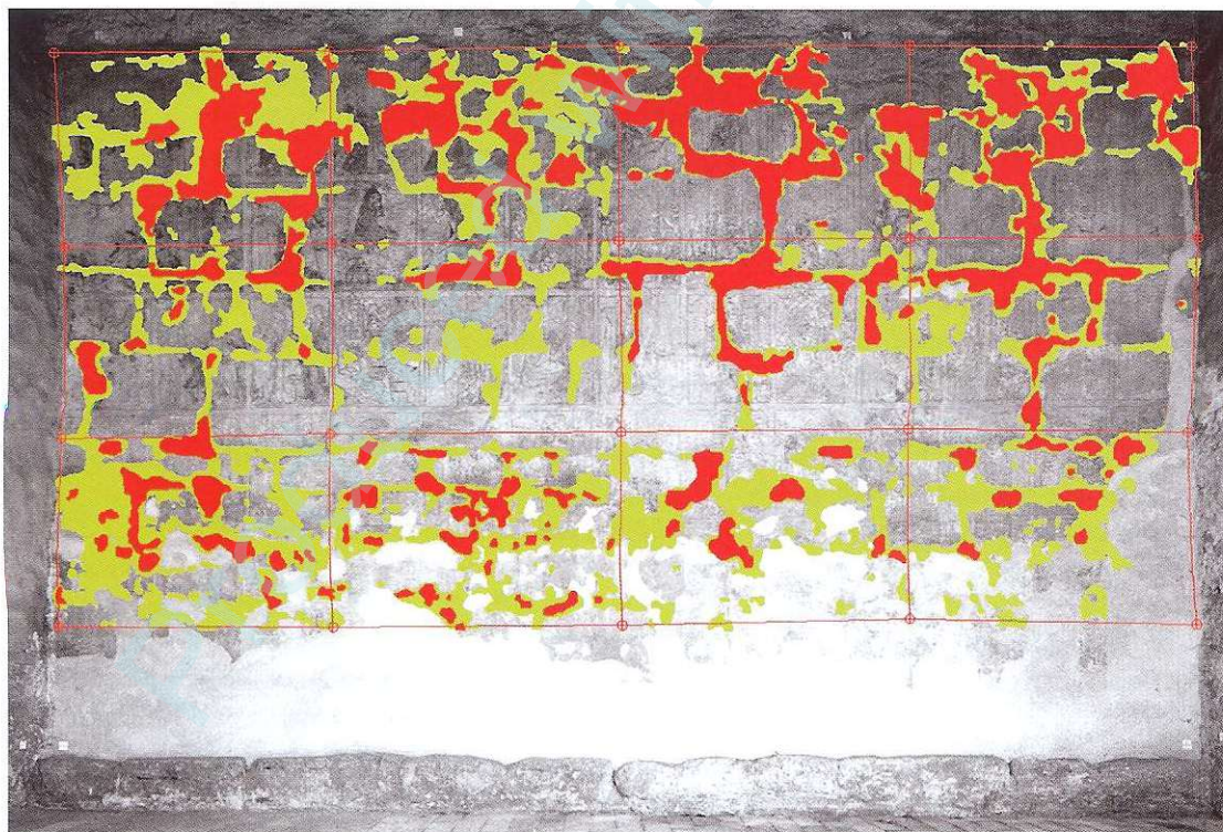
Abb. 31: Schadbildkartierung der entfestigten und hohl liegenden Putzbereiche auf der Wandmalerei
