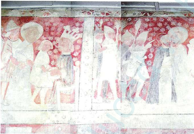
Abb. 20: Wilschdorf, Lichtbild mit Schadenskartierung im Messbereich C
