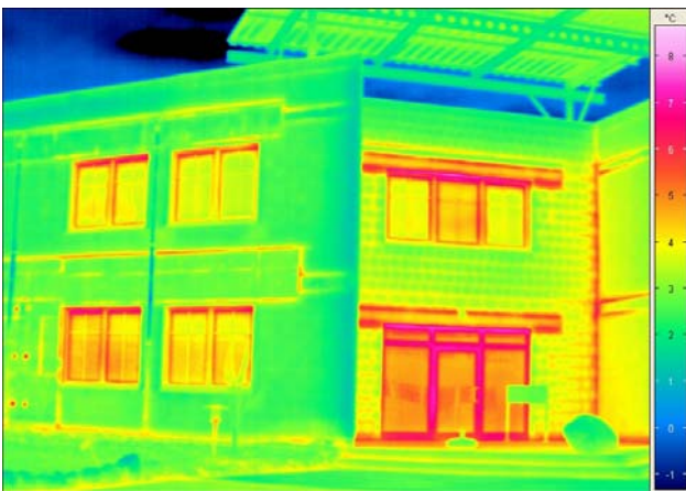
Bild 2: Außenthermografie – Innenecken als geometrisch bedingte Wärmebrücken, undichte Fensterdichtungen, deutlicher Wärmeverlust im Bereich der Türrahmen und Mörtelbrücken sichtbar
